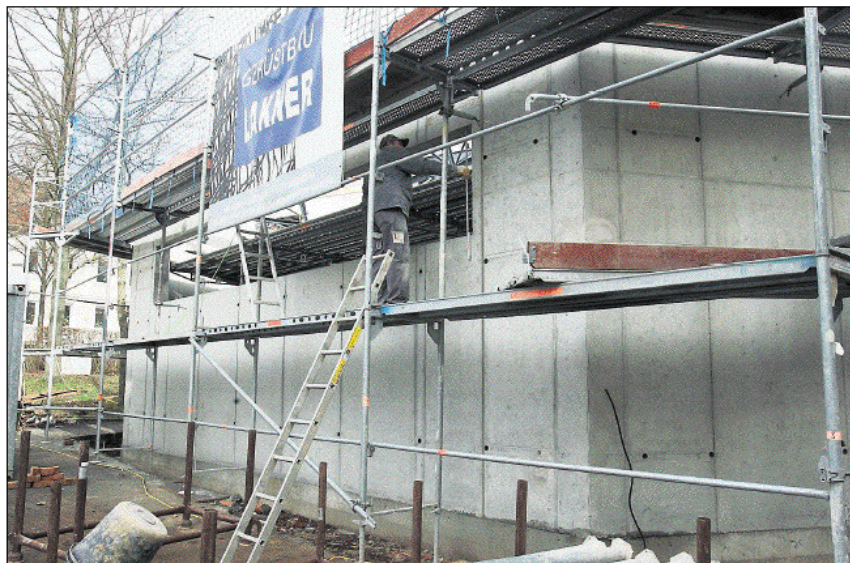
Beton statt Glas: Auf dieser Seite des Konzerthallen-Neubaus sollte sich eine Glasfläche dem Garten zu öffnen. Ohne Genehmigung des Stadtrats wurde die Seitenwand zubetoniert. Kommt jetzt ein Rückbau? Foto: Ritter
